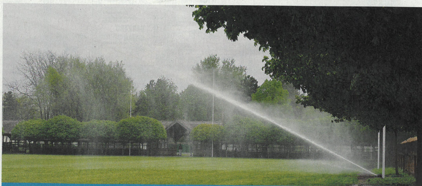
Ott jártunkkor éppen a bemutató tér öntözőberendezésének működését ellenőrizte B. Nagy Zoltán. A 25. kiállításra még ősszel felújították a gyepet, amit már öntözni is tudnak. A 7 bar nyomással dolgozó rendszerrel a teljes terület öntözhető
